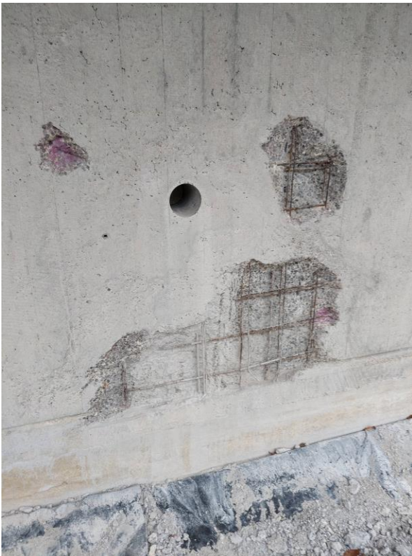
Punktuelle Betonsanierungsarbeiten erforderlich.
